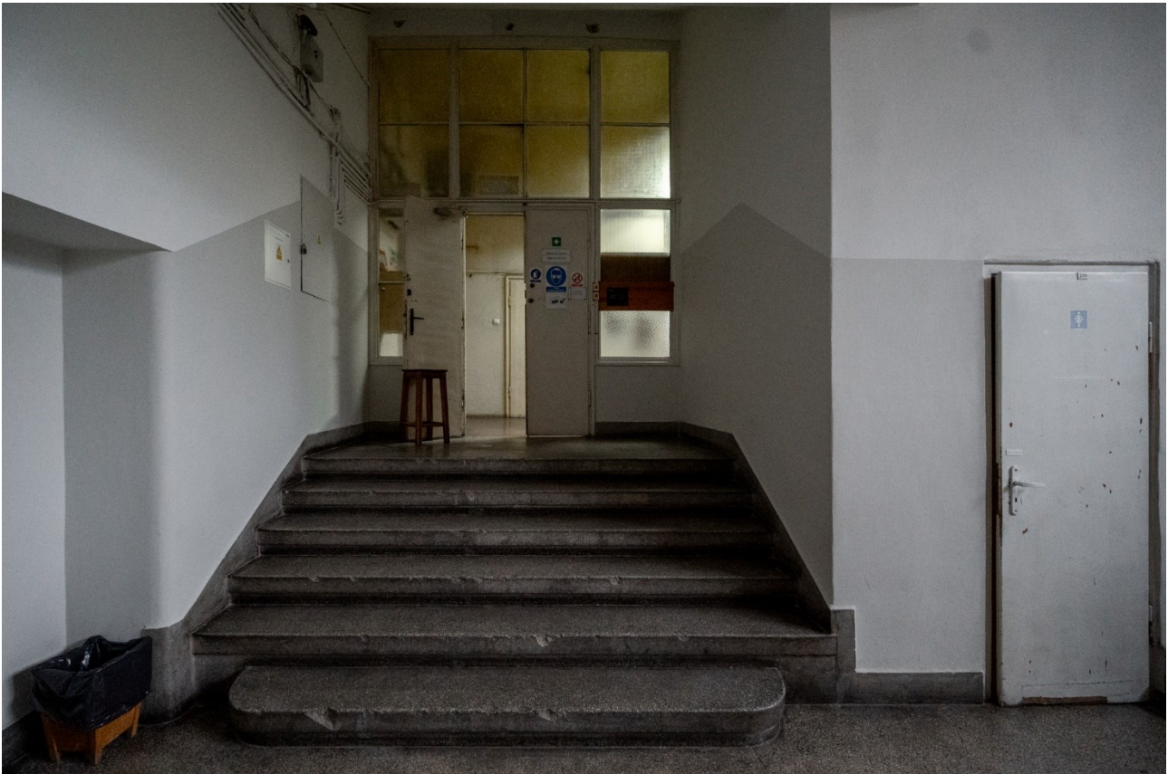
Zdjęcie 17 Widok na różnicę poziomów kondygnacji: parter oraz II-piętro, w obrębie klatki schodowej (K3)
